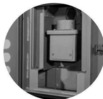
Automatyczne czyszczenie rusztu palnika
